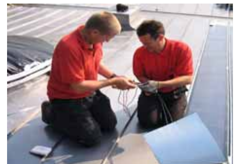
Elektrischer Test eines Laminats vor dem Anschluss. Wenn die Lamine verklebt sind, ist es dafür zu spät.
