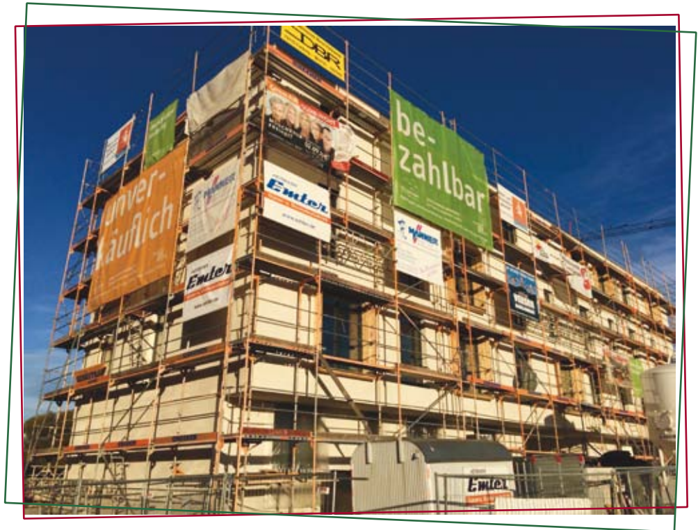
Zwei Gebäude des 3HäuserProjekts sind bereits bezogen, das dritte wird im Frühjahr 2018 fertig. (Foto: Autor)
