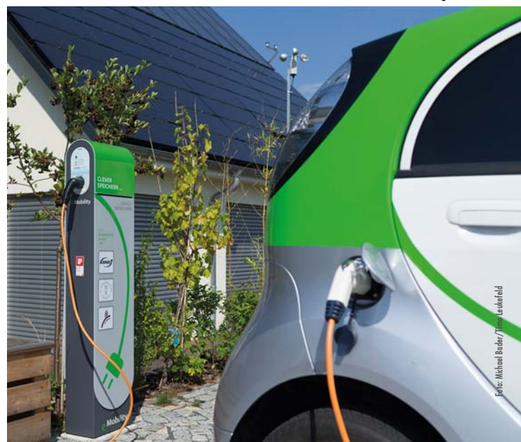
Ladesäule mit bis zu 22 kW Leistung
