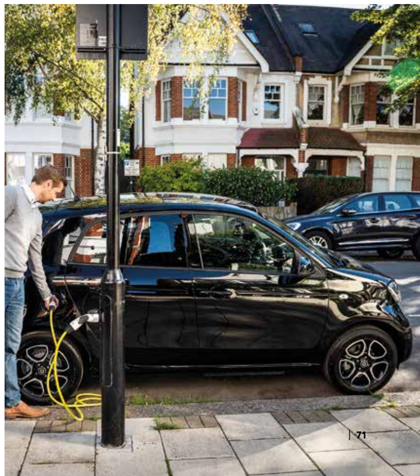
Zähler im Mast: Die britischen Anschlussbedingungen verlangen auch bei Nachrüstungen von Bestandsleuchten keinen „Laderucksack“. (Quelle: Ubitricity)
