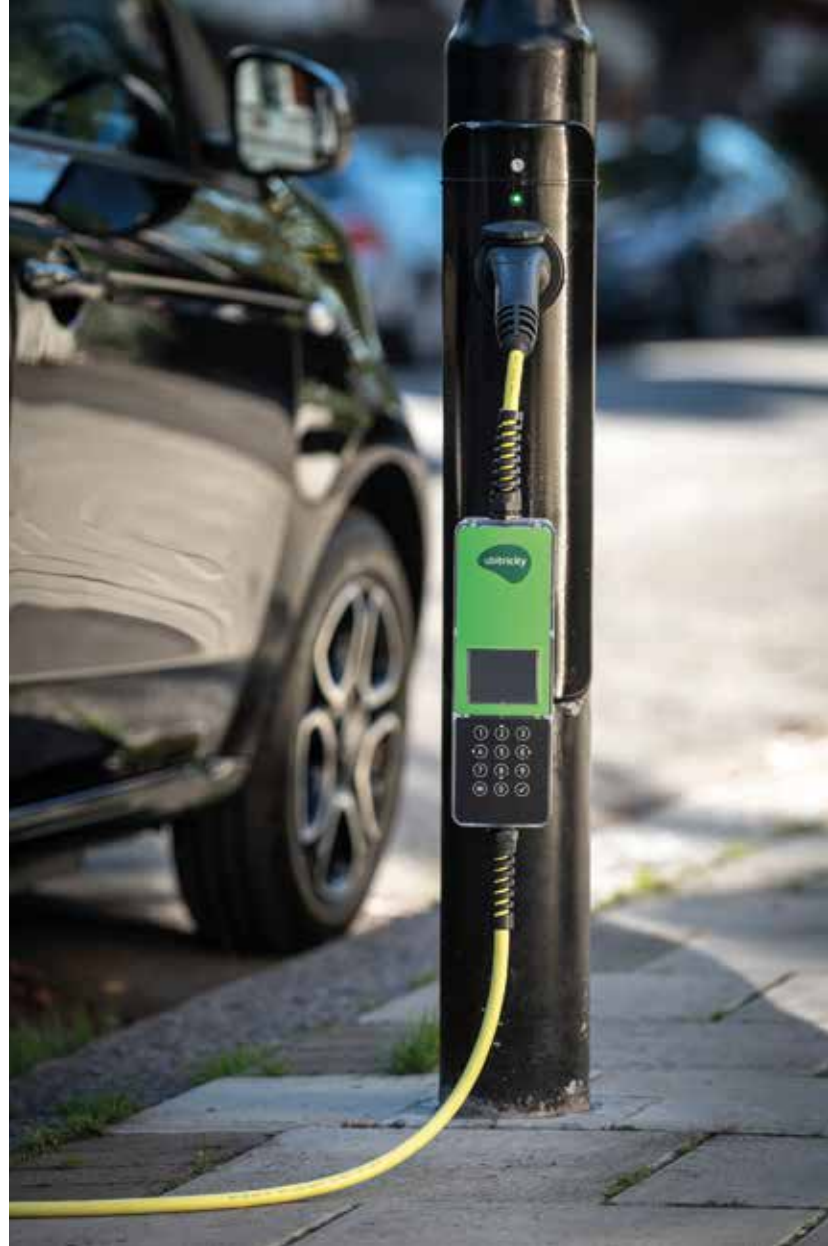
Zähler im Kabel: Das Smart-Cable-System von Ubitricity sollte die Laternenumrüstung besonders kostengünstig machen, konnte sich am Markt aber nicht durchsetzen. (Quelle: Ubitricity)
