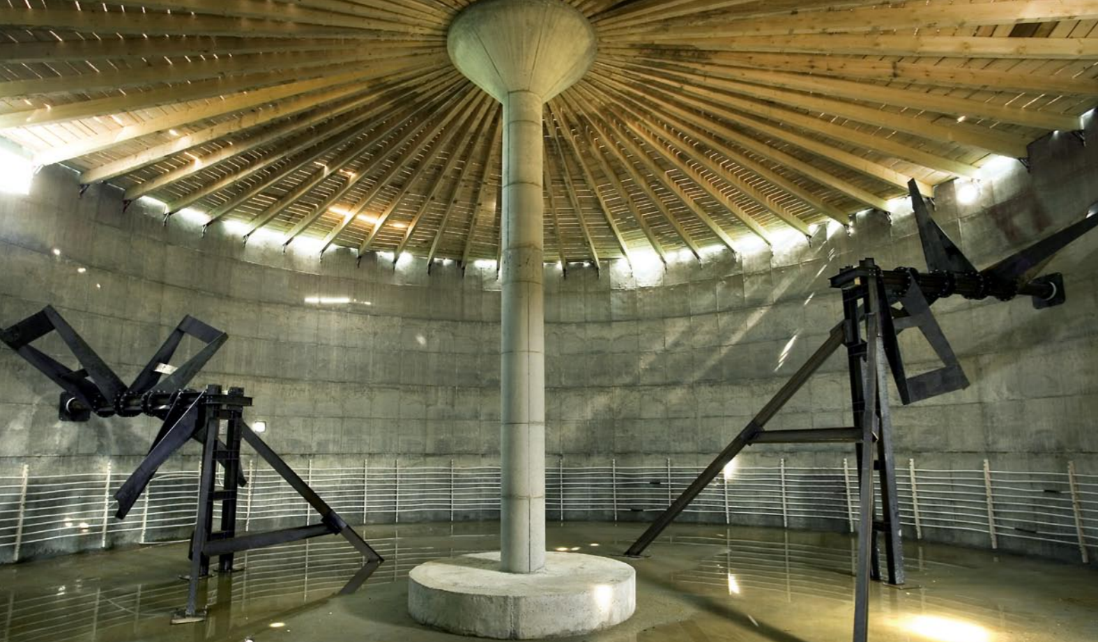
Biogasanlage Neuried: Im so genannten Nachgärer entsteht vorwiegend Methan, das zur Energieerzeugung genutzt wird.
